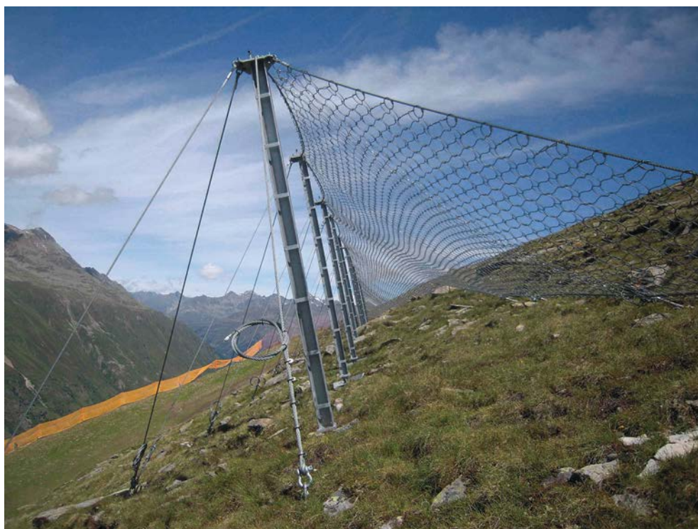
Fig. 12 > Les paravalanches peuvent constituer des atteintes paysagères importantes. On ne devrait pas aménager de pistes nécessitant la construction de paravalanches.
