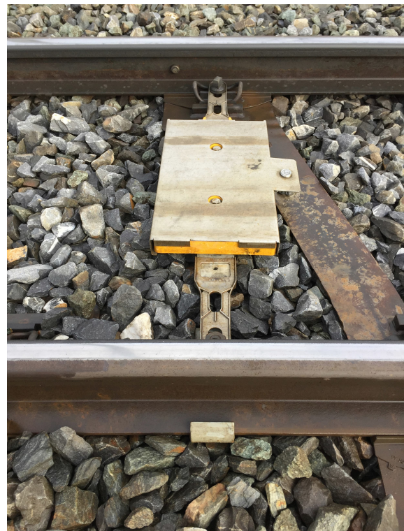
Abbildung 8: Einbaubeispiel Y-Schwellen / Eurobalise mittels Abschirmblech abgedeckt
