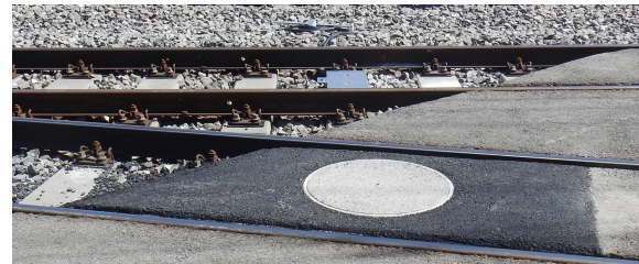
Abbildung 10: Im Strassenkörper eingelassene Balise
