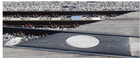
Abbildung 10: Im Strassenkörper versenkte Balise
