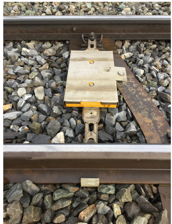
Abbildung 8: Einbaubeispiel Y-Schwellen / Eurobalise mittels Abschirmblech abgedeckt
