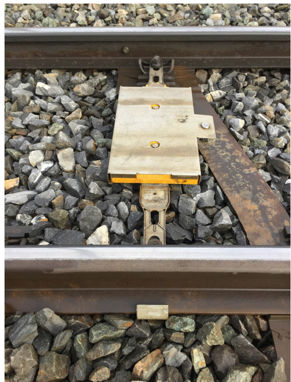
Figura 8: Esempio di installazione su traverse a Y / eurobalise ricoperta da una piastra di schermatura
