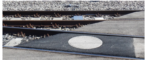
Figura 10: Balise incassata nel corpo stradale
