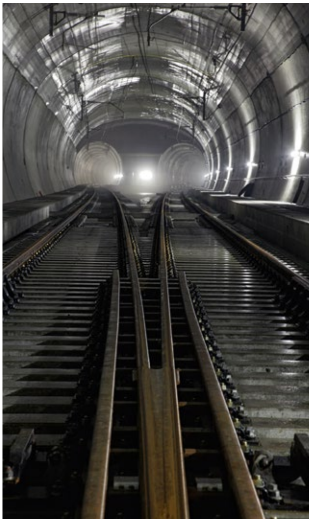
La galleria di base del Lötschberg riduce i tempi di viaggio tra la Svizzera e l'Italia.
