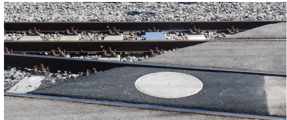
Figure 10: Balise noyée dans le corps de la route
