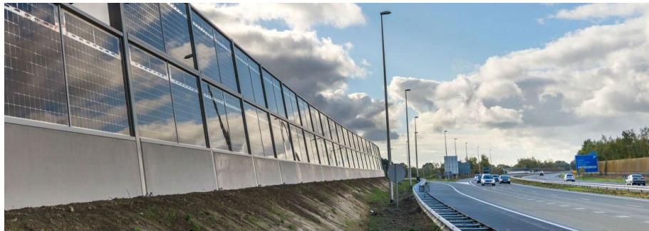
Figure 10 : installation bifaciale intégrée à la PAB le long de l'A50 à Uden, Pays-Bas, dans le cadre du projet Solar Highways [10]
