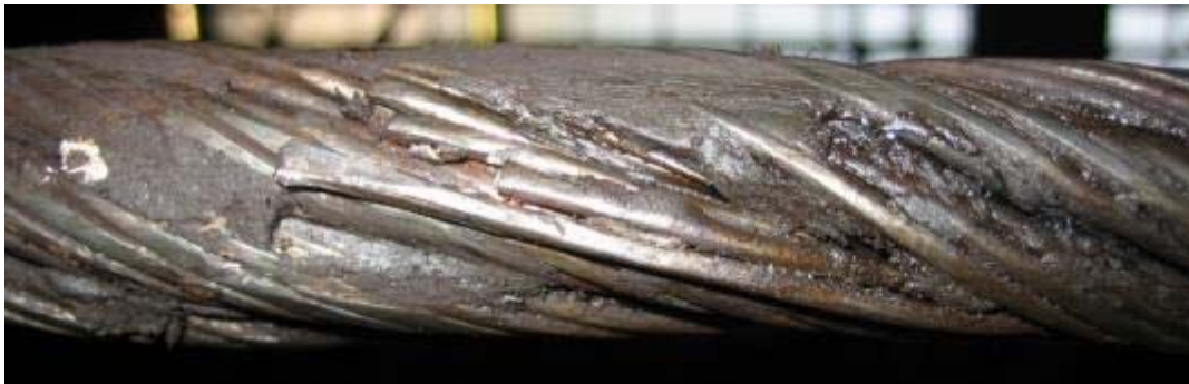
Abbildung 11: Verschmutztes Seil – Inspektion nicht möglich
