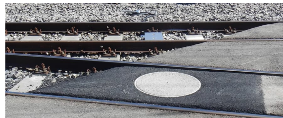
Abbildung 10: Im Strassenkörper versenkte Balise
