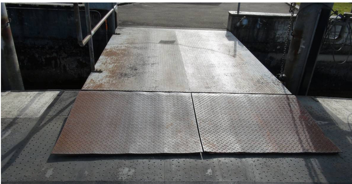
Bilder 1 bis 3: Sicherungen und Verladerampe in Horgen. Fotos: Roger Waller
