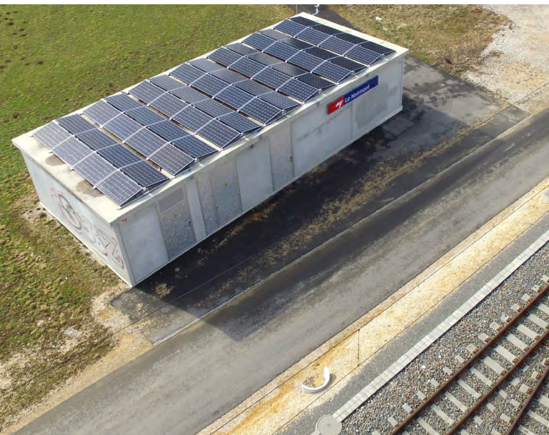
Foto: Société des Forces Électriques de La Goule SA
